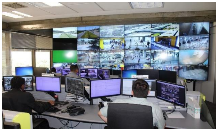
Figura 8 – Centro de Controle Operacional (CCO) Fonte: os autores (2019)
