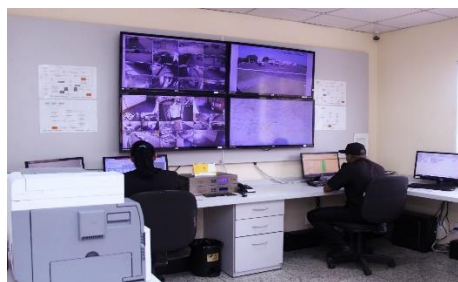
Figura 12 – Centro de Controle Operacional – Empresa X Fonte: os autores (2019)
